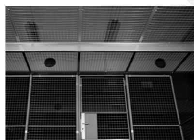
9 PLAFONDS Onze oplossing met gaasdak zorgt voor een goede zichtbaarheid en ventilatie. Niet alleen het licht kan erdoorheen, maar ook het water van sprinklerinstallaties.
