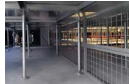
Un ejemplo de revestimiento de malla entre la planta del edificio y el suelo de los equipos.
